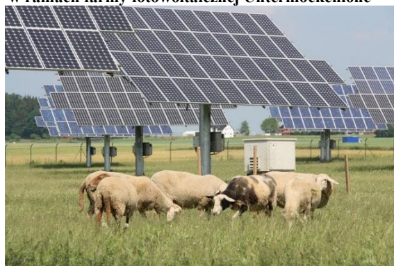
Rysunek 10 Zastosowanie rozwiązania agrofotowoltaiki w ramach farmy fotowoltaicznej Untermöckenlohe
