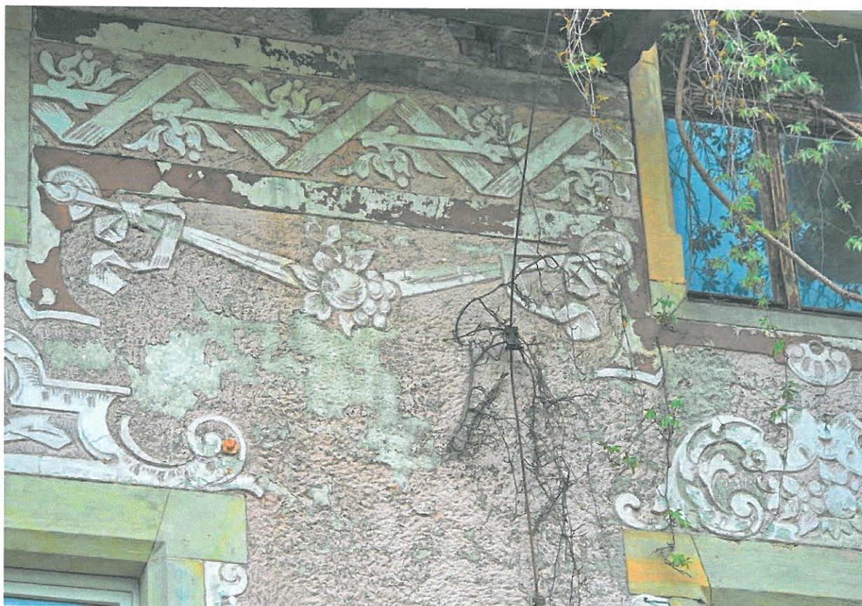
Fot. 17, 18. Elewacja wschodnia – sgraffita w części centralnej - c. d. Na zdjęciu u dołu przykłady zniszczeń powstałych w wyniku zaciekania wody z dachu.
