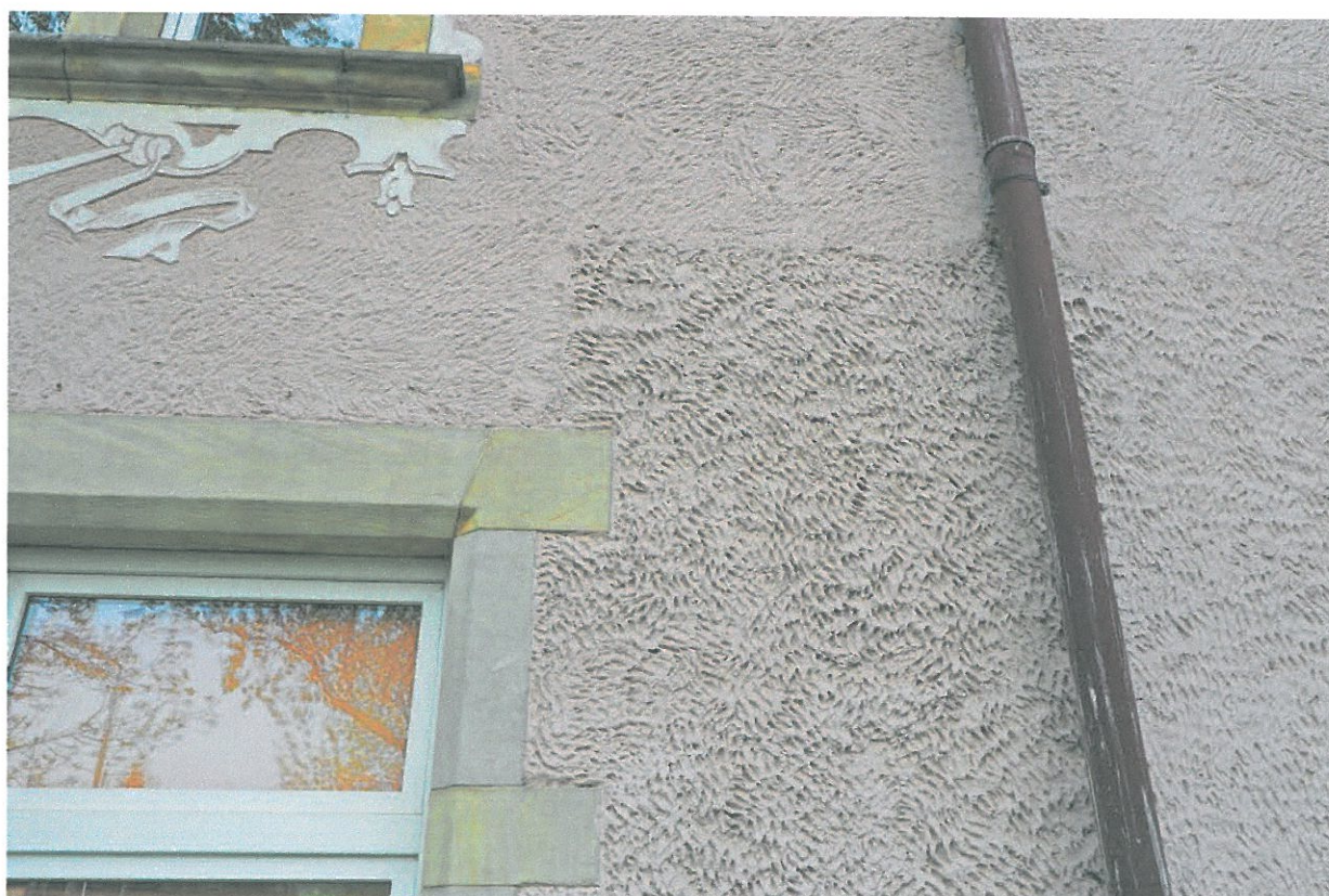
Fot. 14. Różnica faktur tynku oryginalnego (u góry) i wtórnego (u dołu) – przykład z elewacji wschodniej.
