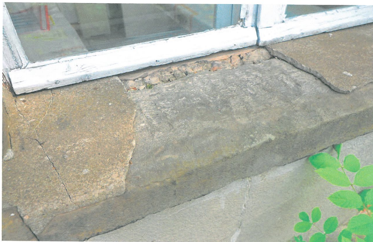
Fot. 33, 34. Stan zachowania kamieniarki piaskowcowej – przykłady z elewacji zachodniej.
